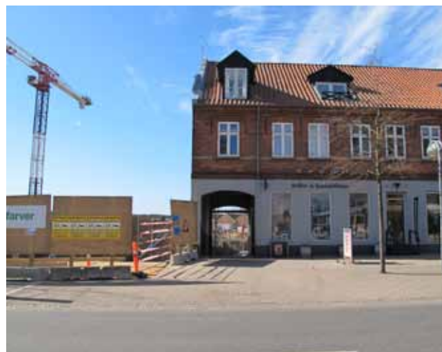
I bymidten kan der ved byfornyelse skabes plads til større virksomheder som fx centerbyggeri, Skanderborg.
